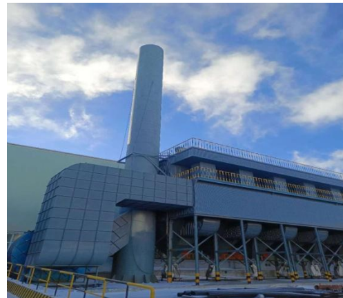
熔炼炉、均质炉布袋除尘系统+排气筒
