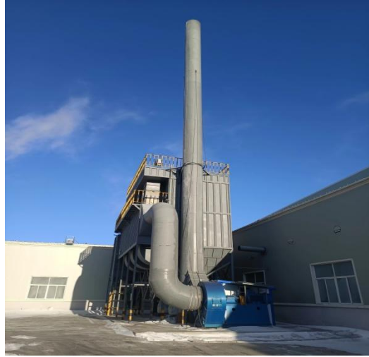
炒灰布袋除尘系统+排气筒
